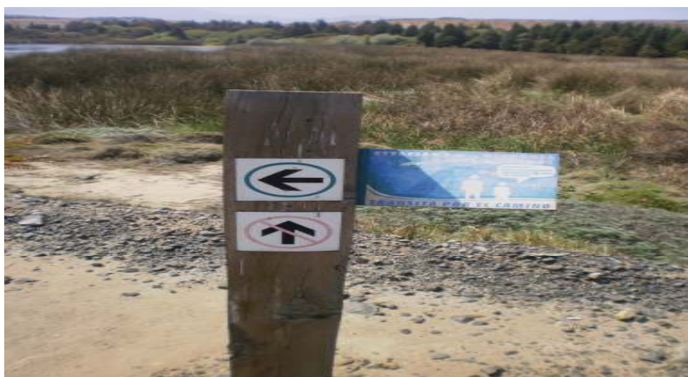
Fig. N°28: Señalética deteriorada en Humedal Campiche. (2003)
